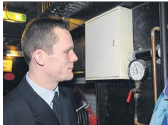
Sprinkleranlage: Riesner prüft den Wasserdruck.
